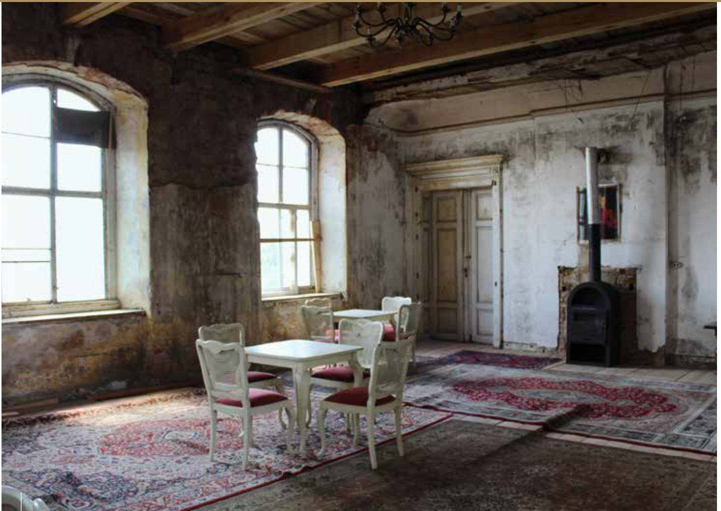
Der Saal von Schloss Promnitz, an dessen Fenstern August der Starke gestanden hat, ist notdürftig gesichert.
