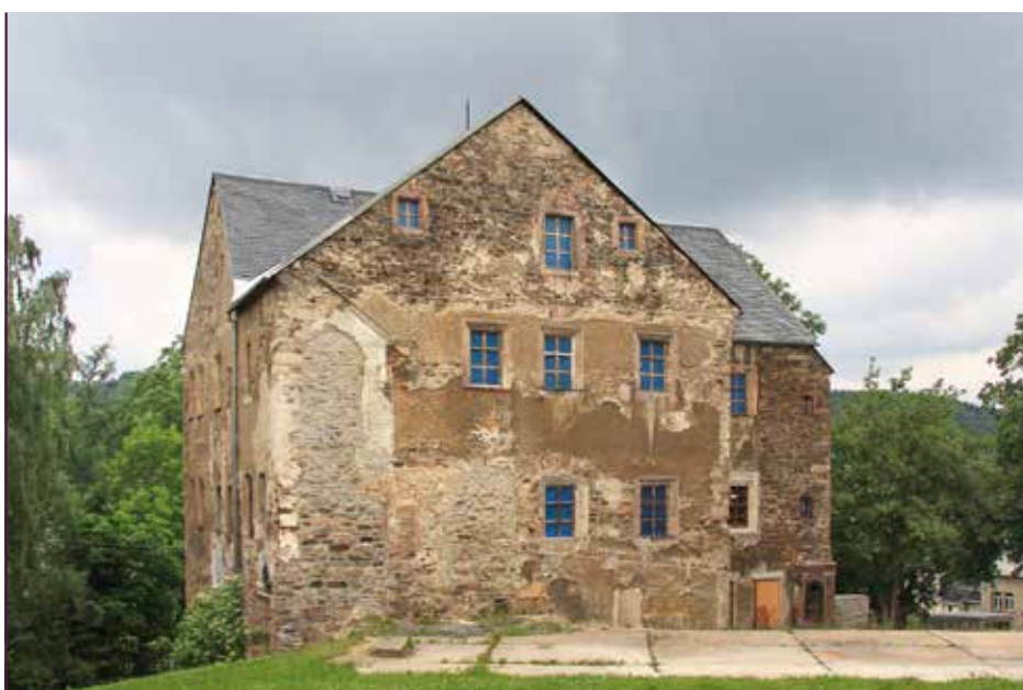
Lotterhof Geyer vor der Außensanierung
