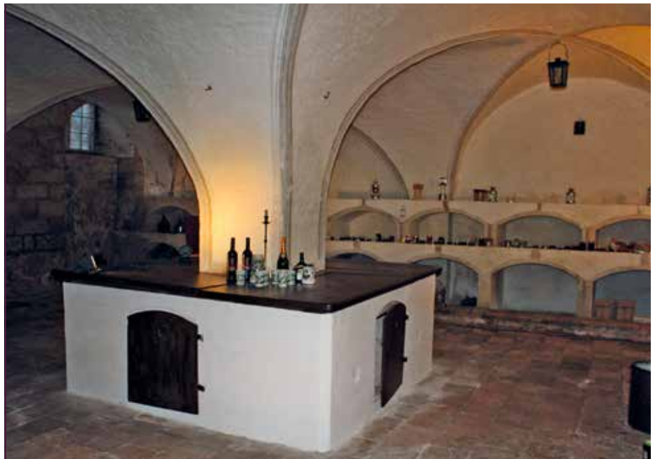
Im wiederhergerichteten Weinkeller werden Weinverkostungen angeboten
