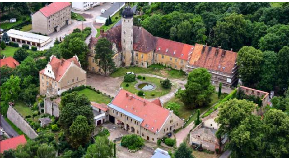
Schloss Schieritz bei Meißen, ehemals Wohnheim der LPG-Hochschule Meißen, wurde vom Freistaat Sachsen an Investoren verkauft, die das Ensemble verfallen lassen. Die Turmhaube musste abgenommen werden.
