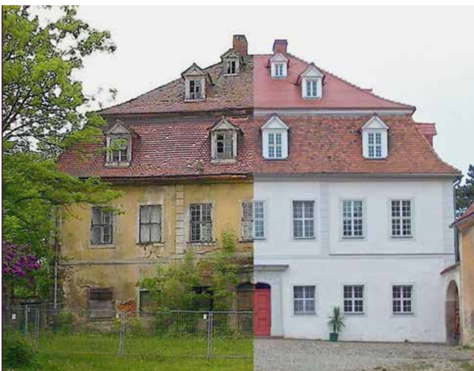
Der Vergleich zeigt, wie stark gefährdet das Baudenkmal war.
